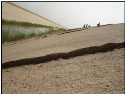
درزهای قدیمی اجرا شده با ماسه آسفالت و بیرون زدگی ماسه
