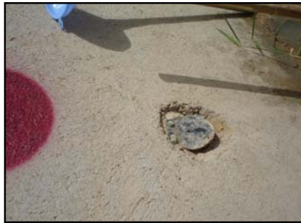
نمایی از درپوش تخریب شده بارباکان
