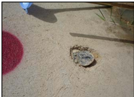
نمایی از درپوش تخریب شده بارباکان
