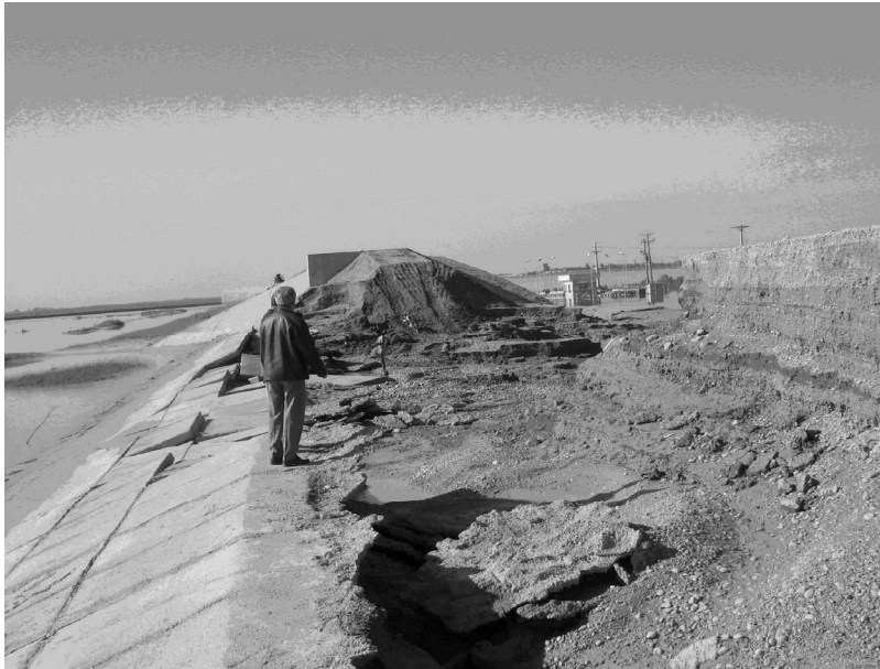
شکل ۷ - شستشوی سریع مصالح بالا دست هسته رسی در جهت جریان آب به سمت فیوز و سرریز کنترل سیلاب (مطابق با نتایج مدل) در اثر ایجاد جریان گردابی
