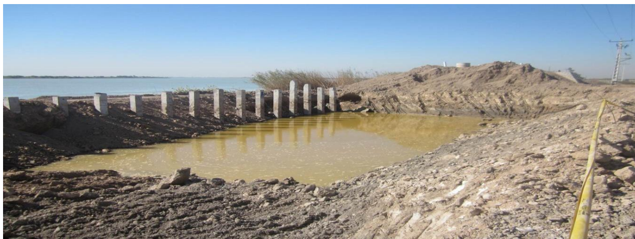
شکل (۷) - خاکبرداری منجر به لجنی شدن زمین
