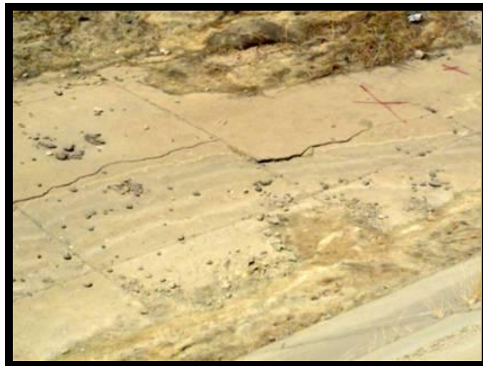
شکل شماره ۵- تخریب کف کانال در اثر نفوذ آب
