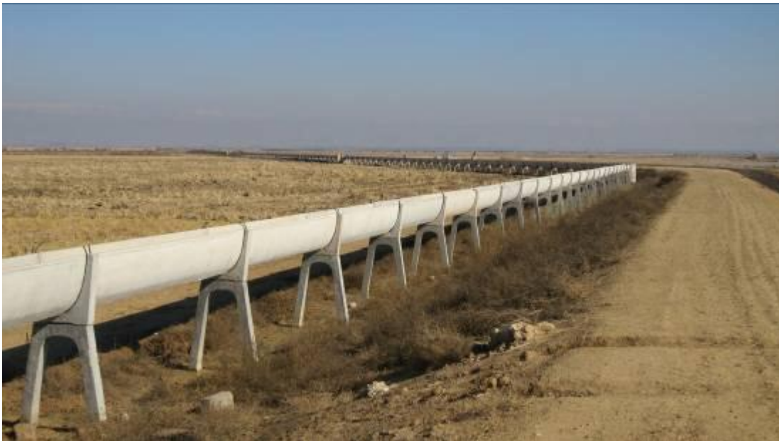
تصویر شماره ۱: کانالت های اجرا شده در شبکه آبیاری و زهکشی داریون ۳ شوشتر
